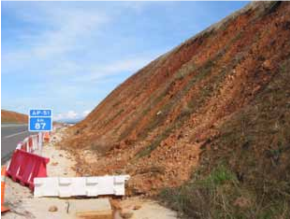
Figura 9. Deslizamientos superficiales del terreno en desmontes de una autopista, que desbaratan las actuaciones de revegetación realizadas sobre los mismos (Foto: J.F. Martín Duque).
