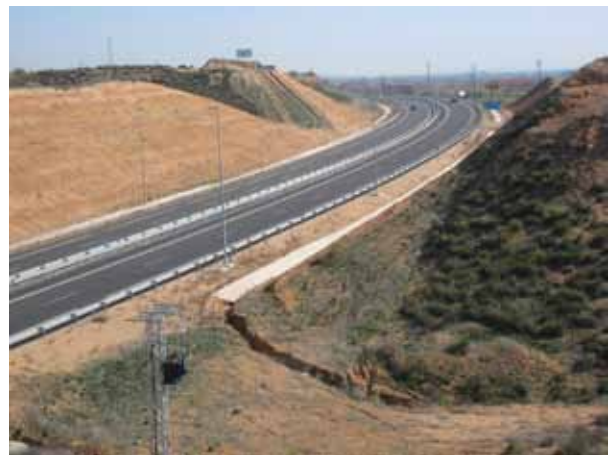
Figura 11. Formación de una cárcava a la salida de una cuneta que recoge la escorrentía procedente del ámbito de una autopista (vías y desmontes). (Foto: J.F. Martín Duque).
