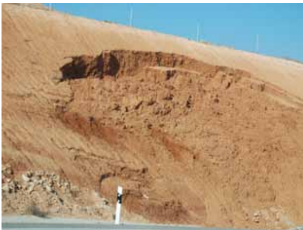
Figura 5. Ejemplo de seepage erosion en un desmonte construido sobre materiales arenosos (Foto: J. Vázquez).
