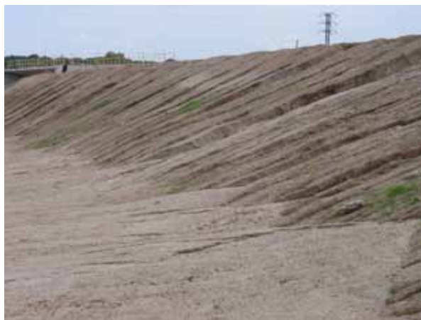
Figura 15. Erosión hídrica muy severa en terraplenes de una autovía. La paralización de las obras impidió el extendido de tierra vegetal y la revegetación durante un largo periodo de tiempo (Foto: J.F. Martín Duque).
