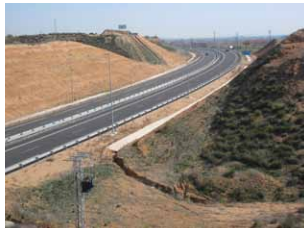
Figura 11. Formación de una cárcava a la salida de una cuneta que recoge la escorrentía procedente del ámbito de una autopista (vías y desmontes). (Foto: J.F. Martín Duque).
