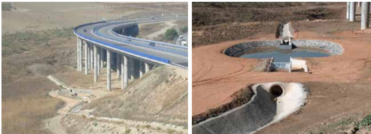
Figura 16. Izquierda: Ejemplo de una balsa de decantación de sedimentos y de contención de vertidos accidentales, conectada al sistema de drenaje de la autopista Radial 4 (Madrid). En la imagen pueden observarse, además de la infraestructura lineal: la bajante desde el terraplén, la cuneta que conduce la escorrentía y los sedimentos a la balsa; el canal de entrada; la balsa; y el vertedero de la balsa a la red fluvial del entorno (arroyo Salinas). Derecha: Detalle de la misma balsa, en el que se aprecian mejor alguno de los elementos que la componen: el canal de entrada, la rejilla de desbaste, la balsa, el canal de vertido y el arroyo Salinas (al fondo) (Fotos: Javier Martínez de Castilla Colomer, Ferroviario – Agromán SA).
