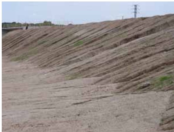
Figura 15. Erosión hídrica muy severa en terraplenes de una autovía. La paralización de las obras impidió el extendido de tierra vegetal y la revegetación durante un largo periodo de tiempo (Foto: J.F. Martín Duque).
