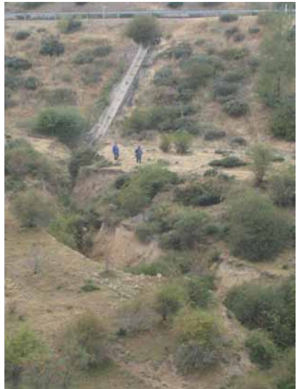
Figura 10. Formación de una cárcava a la salida de una bajante sobre un terraplén. Las cunetas de una autovía interceptan y desvían la escorrentía local, que finalmente es liberada de manera concentrada en este punto, con el consiguiente efecto erosivo (Foto: J.F. Martín Duque).
