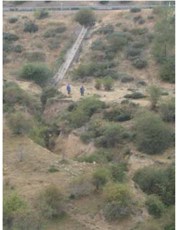
Figura 10. Formación de una cárcava a la salida de una bajante sobre un terraplén. Las cunetas de una autovía interceptan y desvían la escorrentía local, que finalmente es liberada de manera concentrada en este punto, con el consiguiente efecto erosivo (Foto: J.F. Martín Duque).
